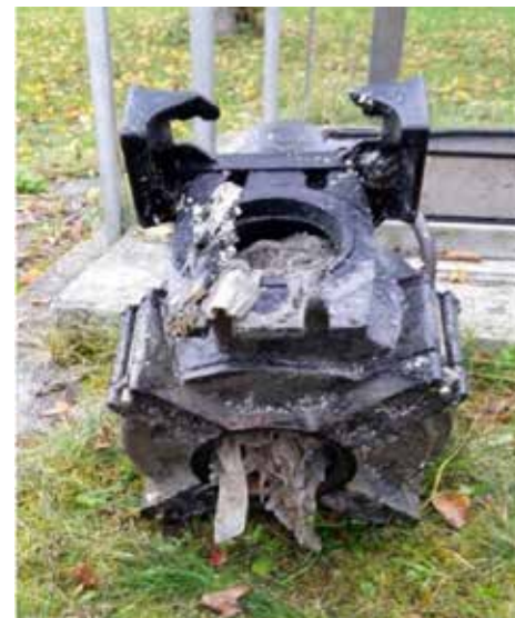
Bsp. Kläranlage Schiltberg: Zulaufpumpe – betriebliche Störung durch Verzopfungen
