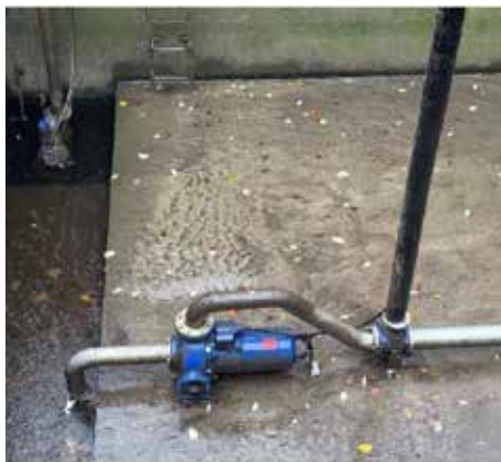
Bsp. Pumpstation Ruppertszell: Entleerungspumpe/Wirbeljet – Reinigungspumpe im Regenüberlaufbecken
